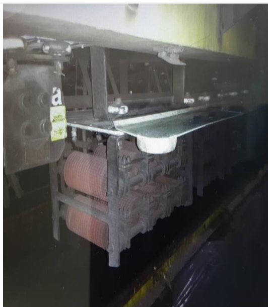
Foto 1 - : Localizados los componentes con asbesto se identifican con la señalización correspondiente para su estudio y posterior desasbestización.
